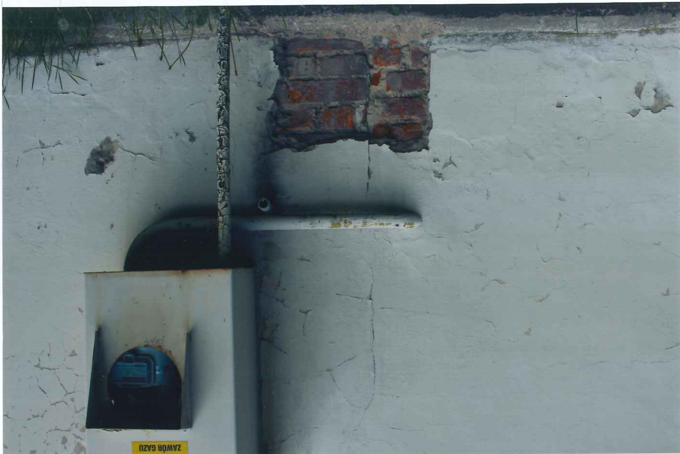
Fot. 44 - Muzeum Historyczne w Bielsku-Białej. Willa Juliana Fałata. Ściana późniejszej przybudówki gospodarczej od strony zachodniej – stan zachowania tynków i farb współczesnych; widoczne bardzo rozległe rozwarstwienia i głębokie odspojenia tynków, tynki i mury zawilgocone i zagrzybione, wyraźne wykwity i odbarwienia tynków. Fot. Jan Gałaszek, maj 2020 r.
