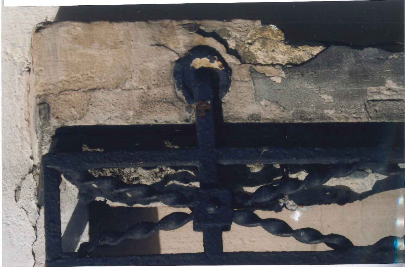
Fot. 7 - Muzeum Historyczne w Bielsku-Białej, Willa Juliana Fatata. Bardzo zły stan zachowania betonowych parapetów okiennych oraz metalowych kutych oston doniczkowych. Oryginalny sposób zamocowania uchwytów mocujących w postaci wtopionych w beton metalowych tulejek. Fot. Jan Gataszek, maj 2020 r.
