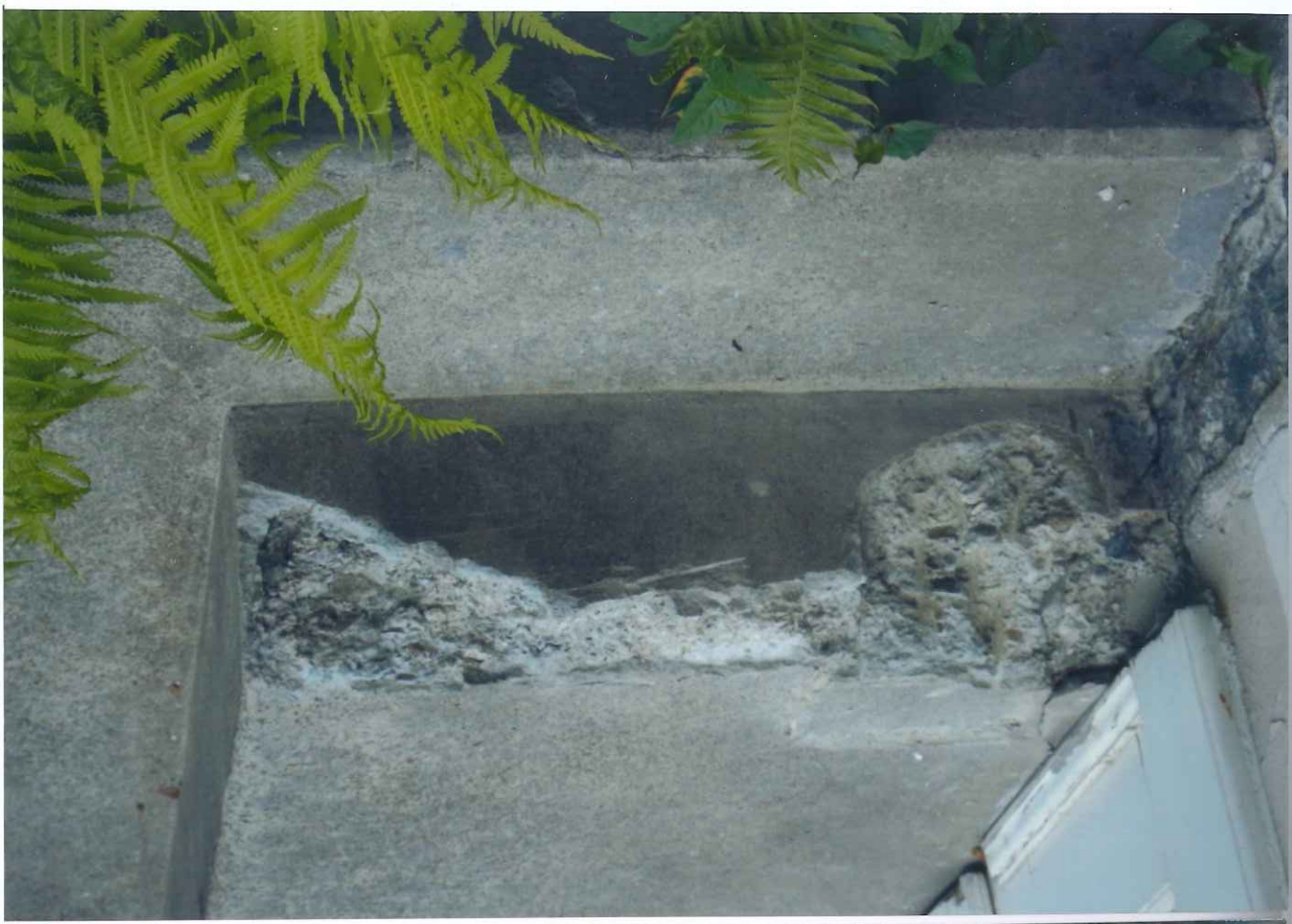
Fot. 11 - Muzeum Historyczne w Bielsku-Białej. Willa Juliana Fatata. Stan zachowania betonowych schodów głównych oraz tynku w części dolnej ściany od strony wschodniej wneki drzwiowej. Fot. Jan Gałaszek, maj 2020 r.
