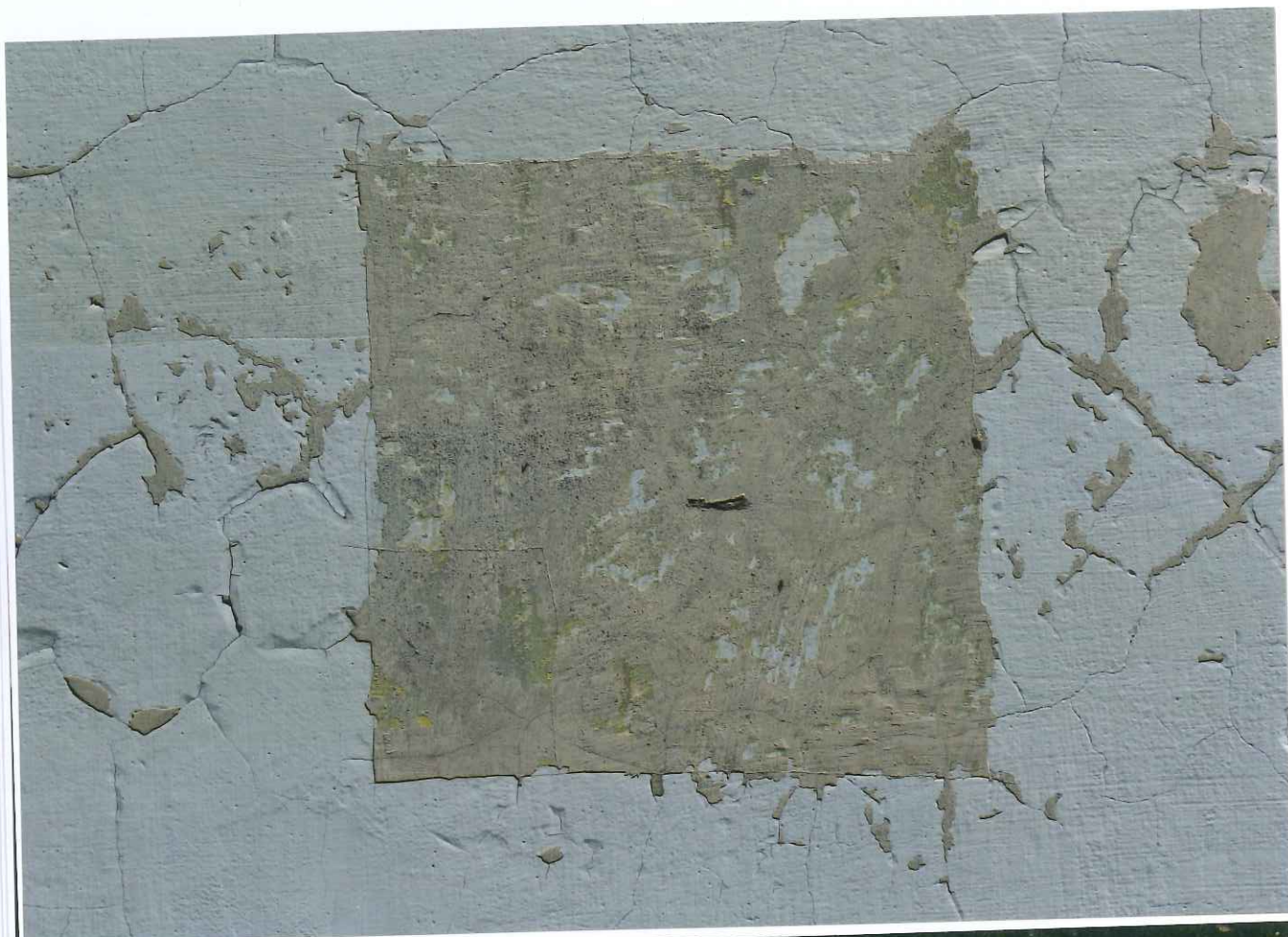
Fot. 41 - Muzeum Historyczne w Bielsku-Białej. Willa Juliana Fałata. Odkrywka farb i tynków wykonana w części ściany pomiędzy oknami parteru na elewacji od strony zachodniej budynku. Fot. Jan Gałaszek, maj 2020 r.
