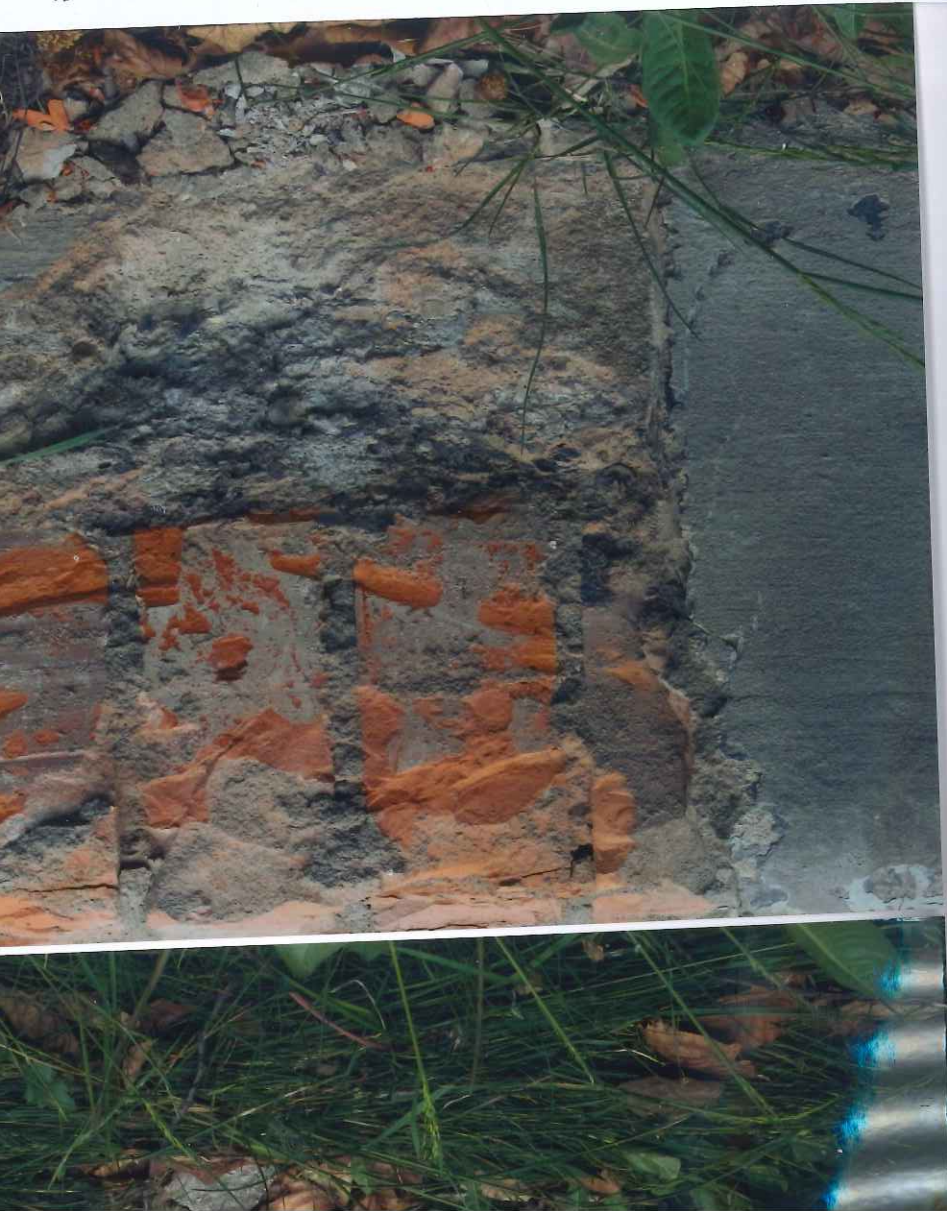
Fot. 14 - Muzeum Historyczne w Bielsku-Białej, Willa Juliana Odkrywka na cokole biegnącym wokół przybudówki starszej stwa współczesnej zaprawy cementowej znajduje się cokol z wyprofilowanej zaokrąglonej w górnej części cegły kładzion wy fundament. Fot. Jan Gałaszek, maj 2020 r.
