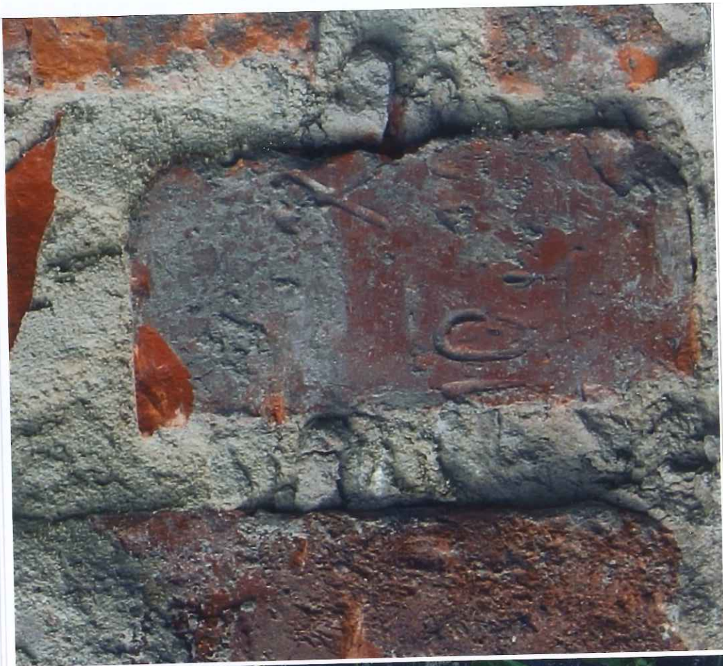
Fot. 45 - Muzeum Historyczne w Bielsku-Białej. Willa Juliana Fatata. Fragment odsłoniętego muru ceglano-żelaznego w miejscu łączenia ściany korpusu głównego willi z późniejszą przybudówką gospodarczą. Fot. Jan Galaszek, maj 2020 r.
