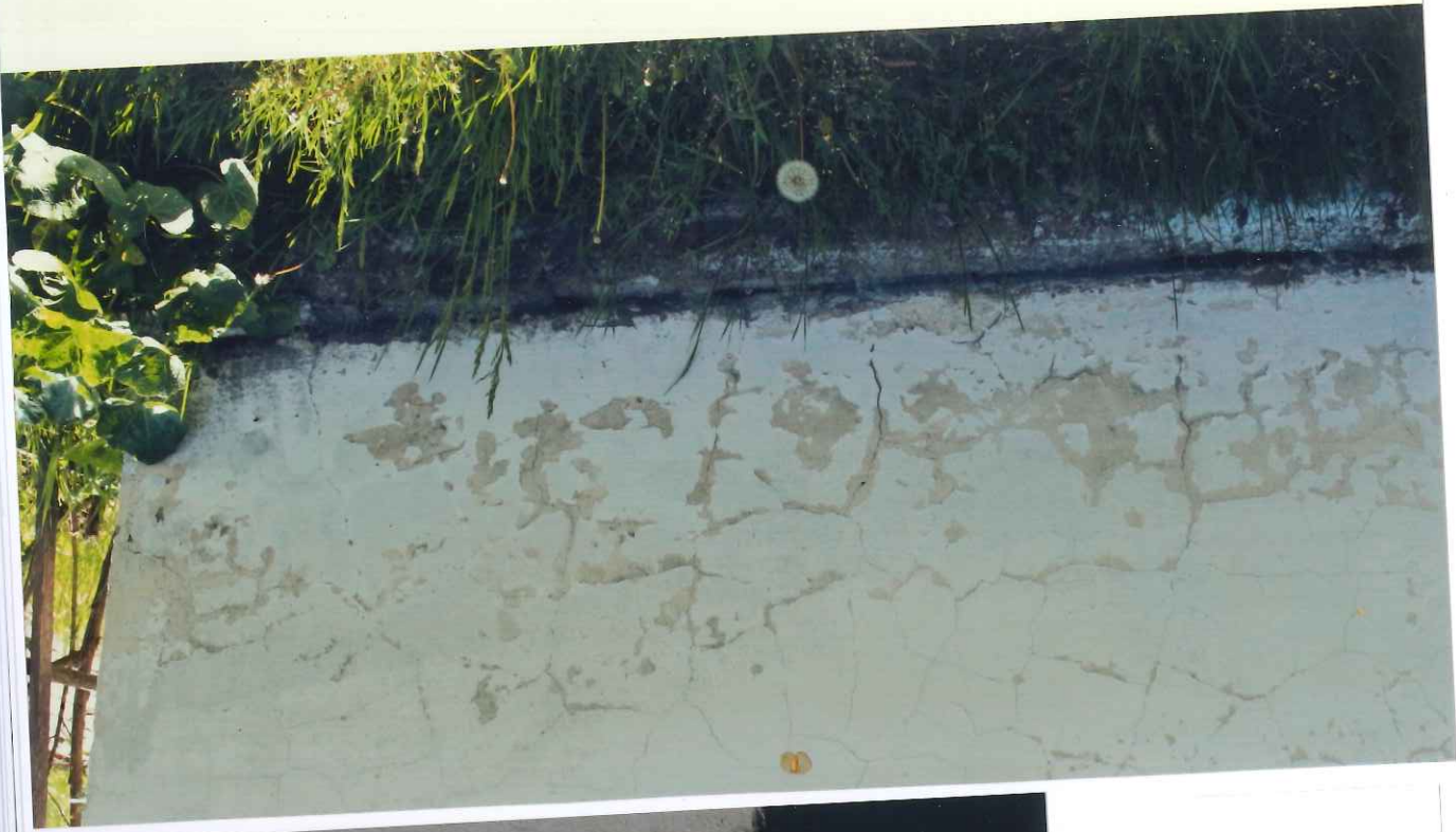
Fot. 37 - Muzeum Historyczne w Bielsku-Białej. Willa Juliana Fałata. Elewacja zachodnia, stan muru i tynku; widoczne liczne spękania, złuszczenia i odspojenia tynków i farb. Fot. Jan Galaszek, maj 2020 r.
