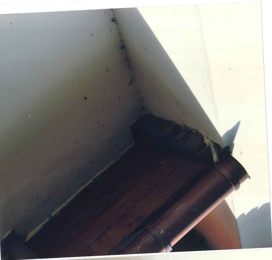
Fot. 25 - Muzeum Historyczne w Bielsku-Białej, Willa Juliana Fatata. Elewacja południowa, część wschodnia - uszkodzenia drewna krokwi oraz tynków.
