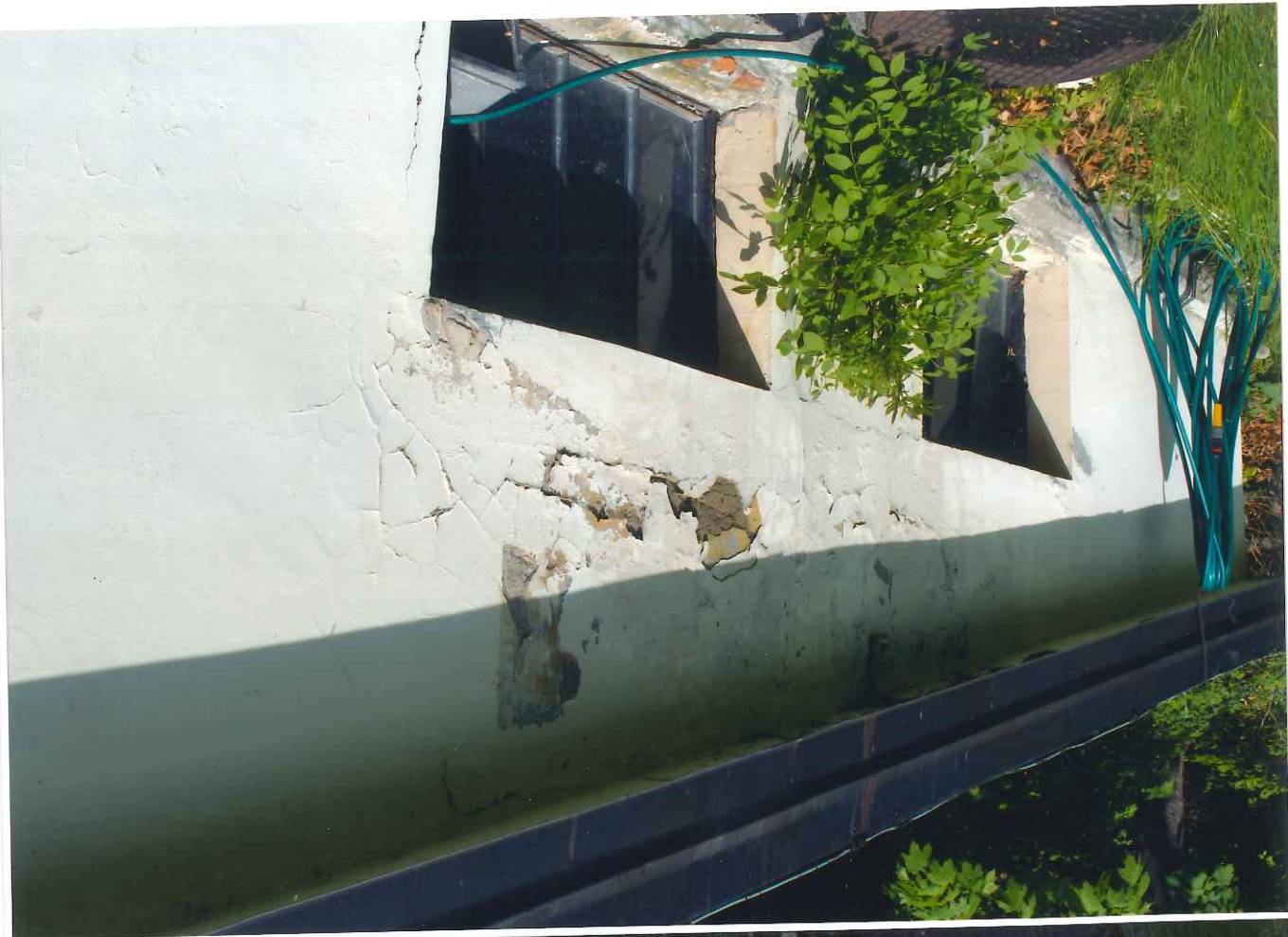
Fot. 42 - Muzeum Historyczne w Bielsku-Białej; Willa Juliana Fałata. Elewacja zachodnia - odkrywka tynków i farb. Fot. Jan Gataszek, maj 2020 r.
