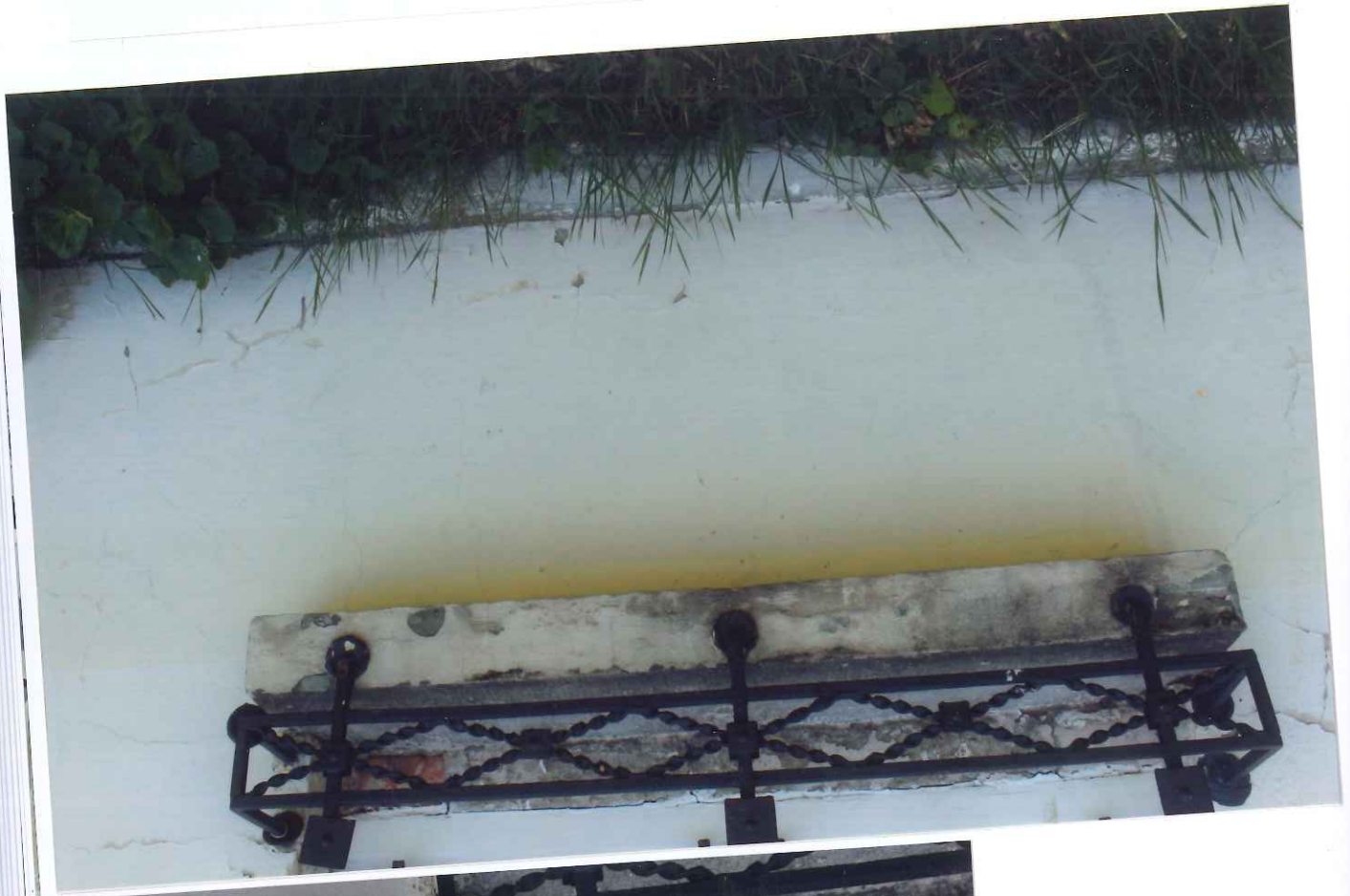
Fot. 38 - Muzeum Historyczne w Bielsku-Białej. Willa Juliana Fatata. Elewacja zachodnia, stan muru i tynku; widoczne liczne spękania, złuszczenia i odspojenia tynków i farb. Fot. Jan Gataszek, maj 2020 r.
